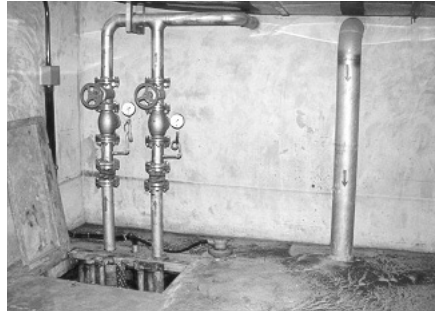
사진 9. 유량조정용 배관 및 반송배관
