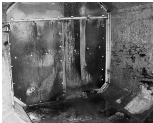
사진 1. 1 지점의 우수관내 악취 차단설비
