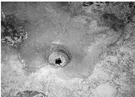
사진 10. 102동앞 공동구 관리층내
